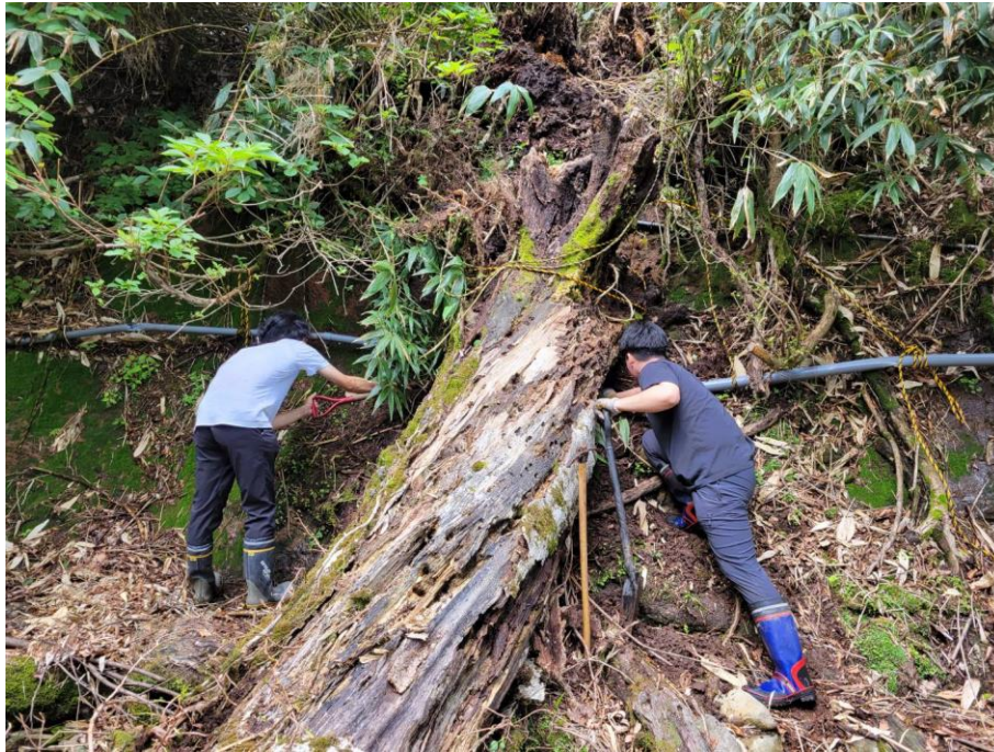
図4 大木により水道管がつぶれているところ、ほって見ている様子。
